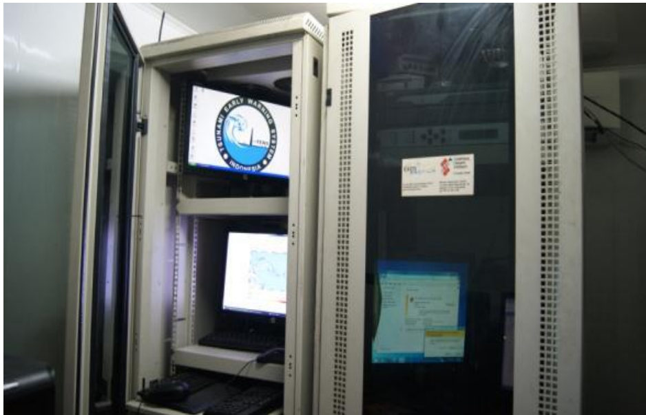
Gambar 13. Foto Ruang Server WRS BMKG untuk informasi Gempabumi dan Peringatan Dini Tsunami
