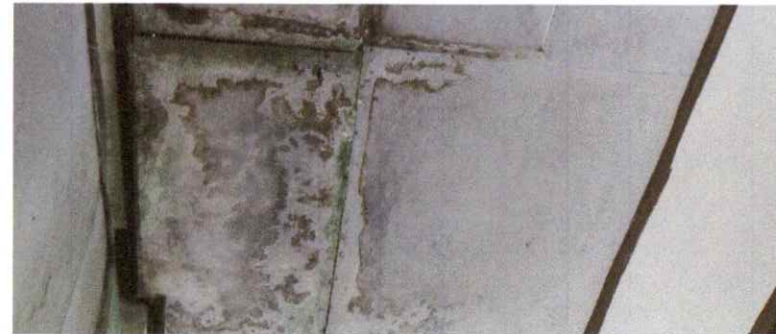
Kerusakan pada plafond akibat kebocoran atap
