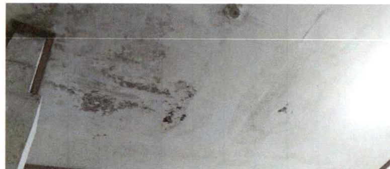
Kerusakan pada plafond akibat kebocoran atap
