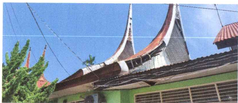
Kerusakan pada atap
