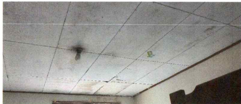
Kerusakan pada plafond akibat kebocoran atap
