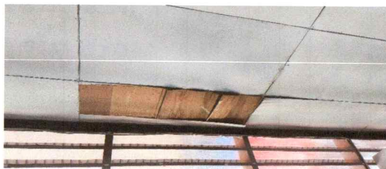
Kerusakan pada penutup plafond karena kebocoran atap
