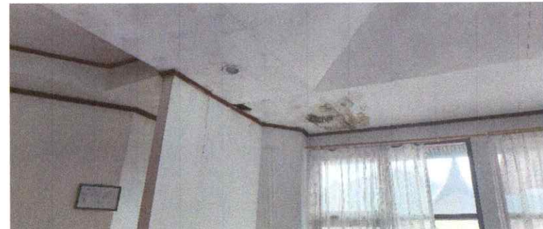
Kerusakan pada plafond akibat kebocoran atap
