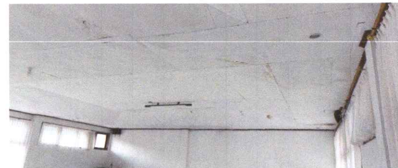
Kerusakan pada plafond akibat kebocoran atap
